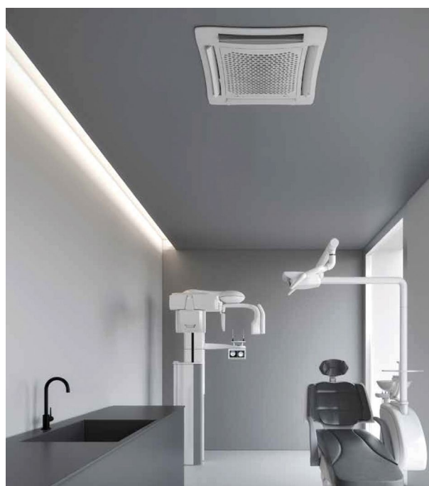
Instalação SKYSAFE em teto falso.
