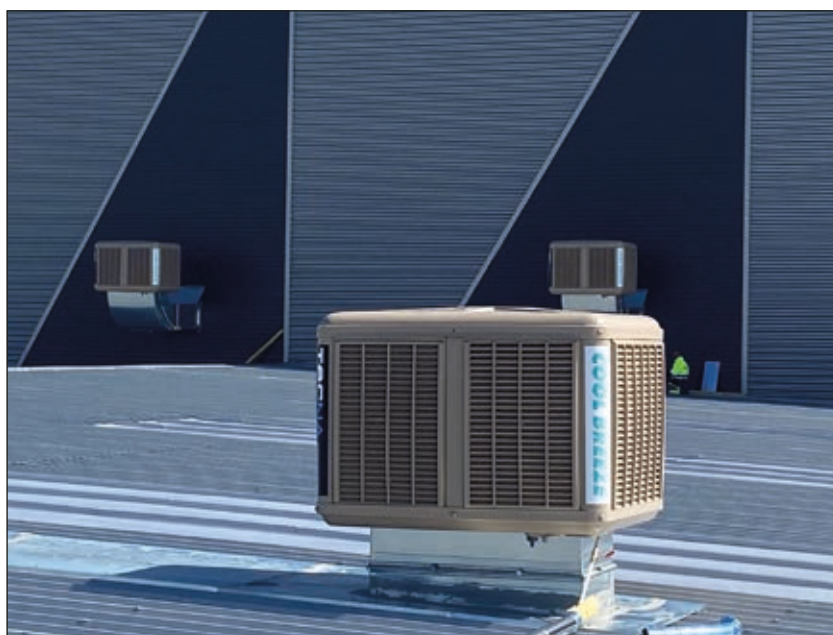
Instalación de 18 Unid. QA-500 integrados con el control domótico INTELLITOUCH en la nueva nave de NISSAN (Ávila)
