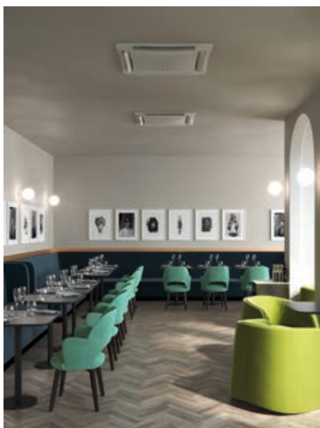
SKYSAFE en falso techo
