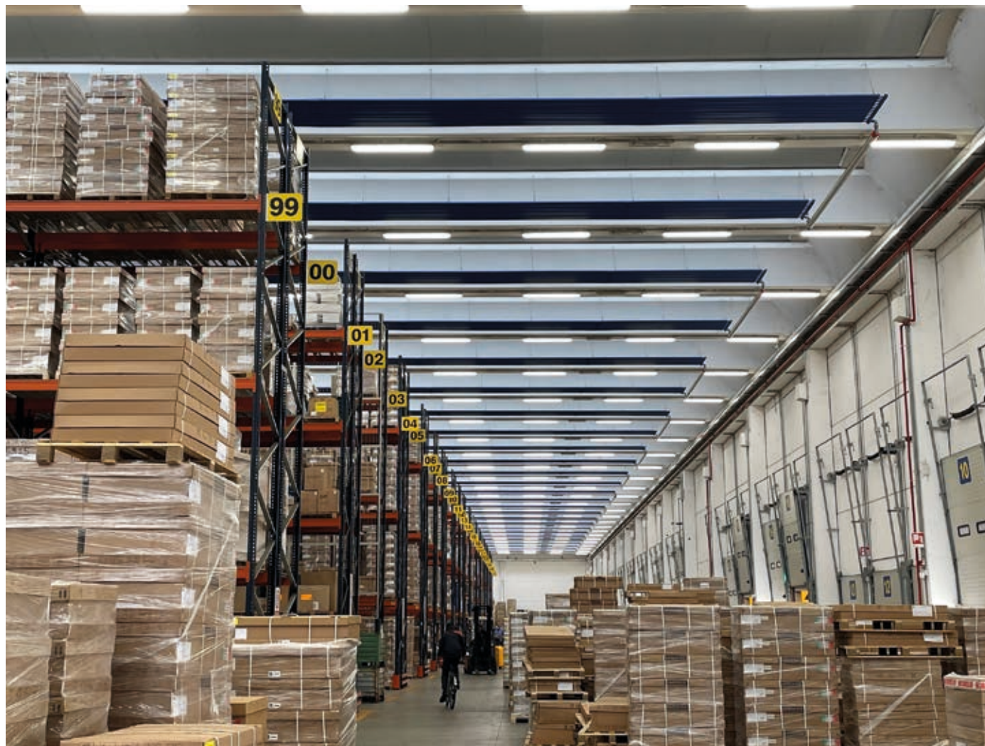
Instalación de calefacción con paneles radiantes SABIANA en el almacén de SABIANA (Italia).
